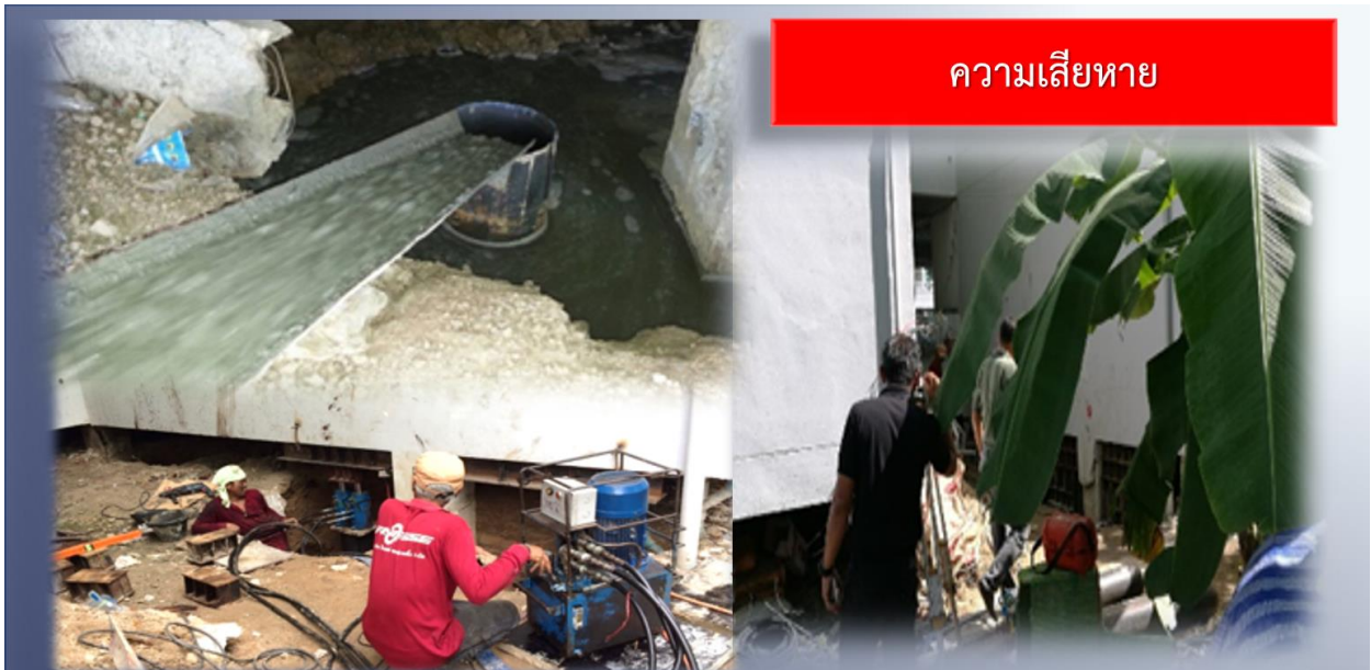
เทคอนกรีตเสาเข็ม เพื่อใช้เป็นค้ำยันชั่วคราว ติดตั้งโครงสร้างค้ำยันชั่วคราวเพื่อถ่ายน้ำหนักอาคารลงสู่เสาเข็มใหม่ โดยการ Pre-load ตรวจจวัดการเคลื่อนตัวของเสาตอม่อในระหว่างซ่อมแซมด้วยกล้องระดับ
