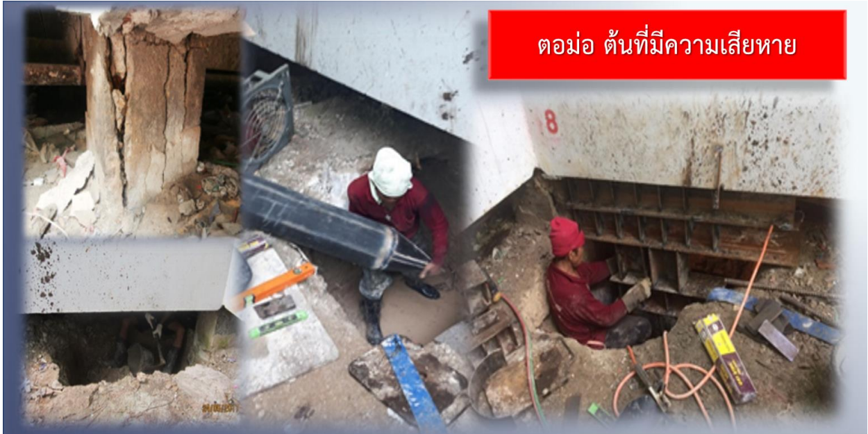
ขุดดินหาขนาดฐานราก ติดตั้งเสาเข็มโดยการกดด้วยเครื่องกดไฮดรอลิกเพื่อใช้เป็นค้ำยันชั่วคราว ในขณะที่ซ่อมแซมเสาตอม่อ
