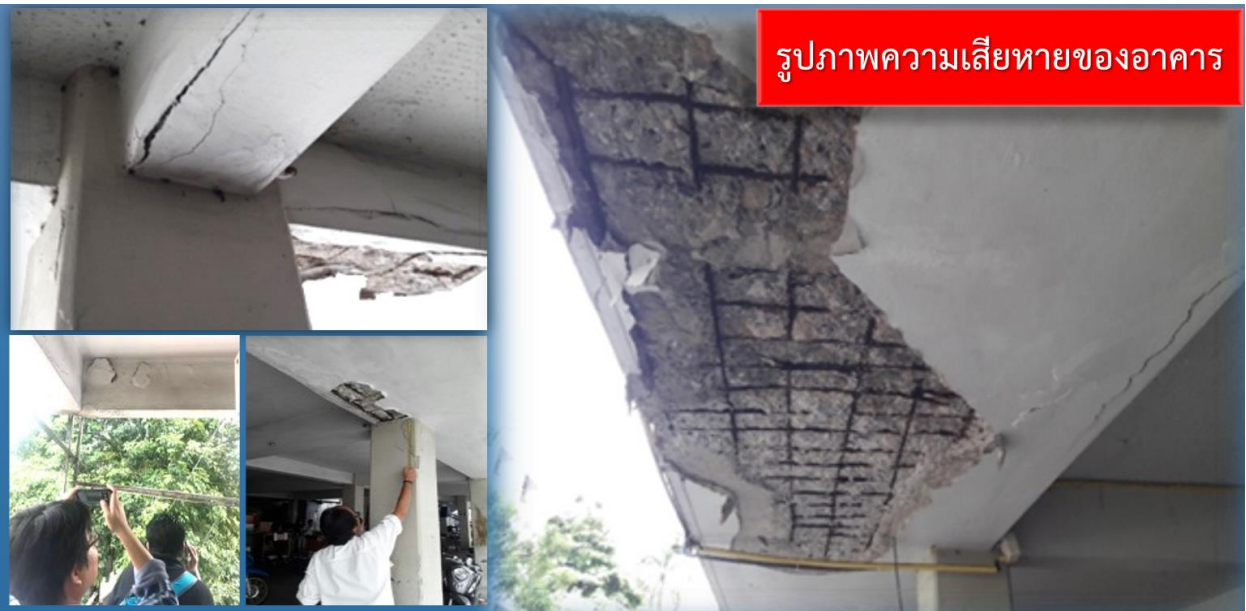
ภาพความเสียหายแผงกันสาด ,คาน
