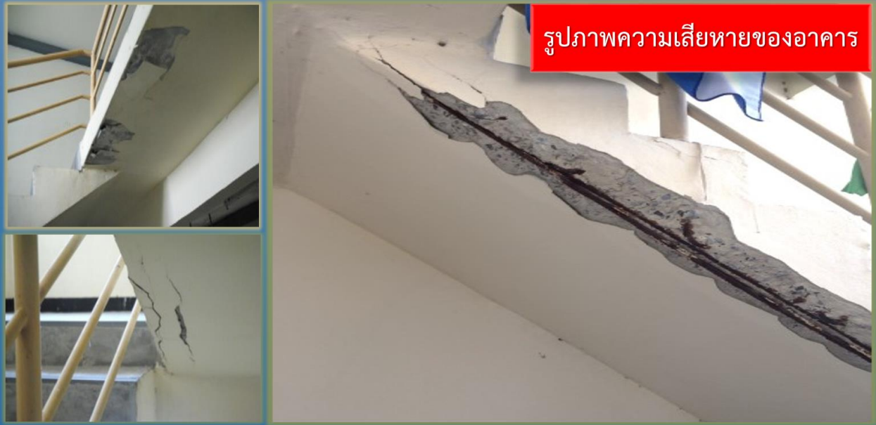
ภาพความเสียหายบริเวณบันไดอาคาร
