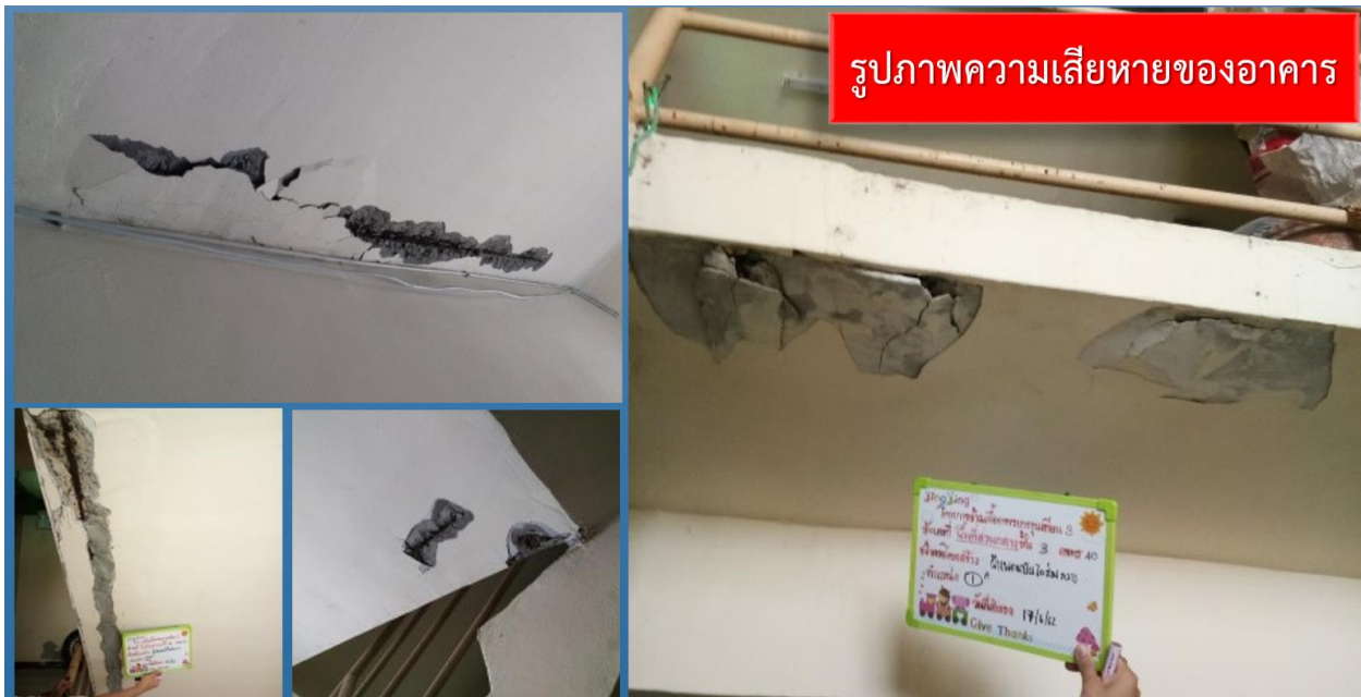
ภาพความเสียหายบริเวณบันไดอาคาร
