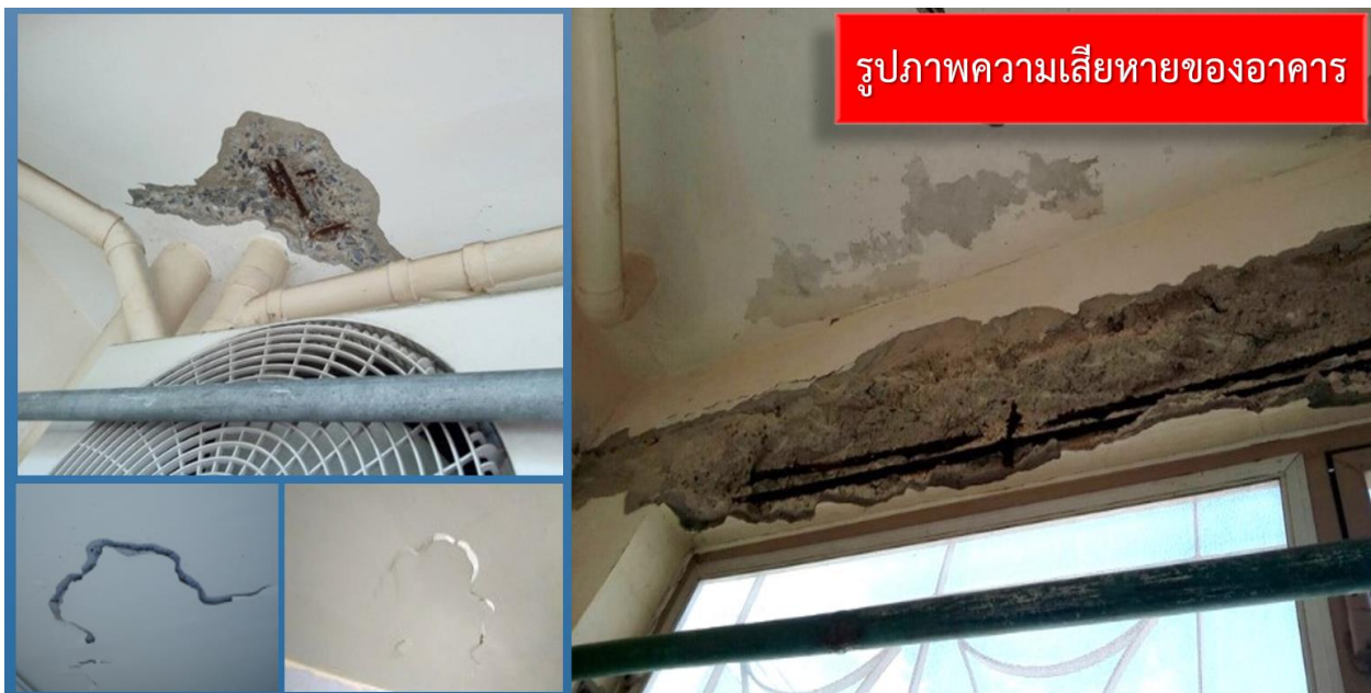
ภาพความเสียหายฝ้าดาน,แนวคานภายใน ห้องพักอาศัย
