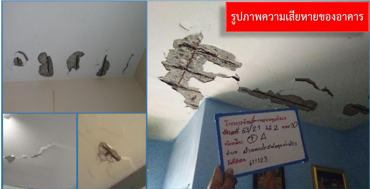
ภาพความเสียหายฝ้าดานภายในห้องพักอาศัย
