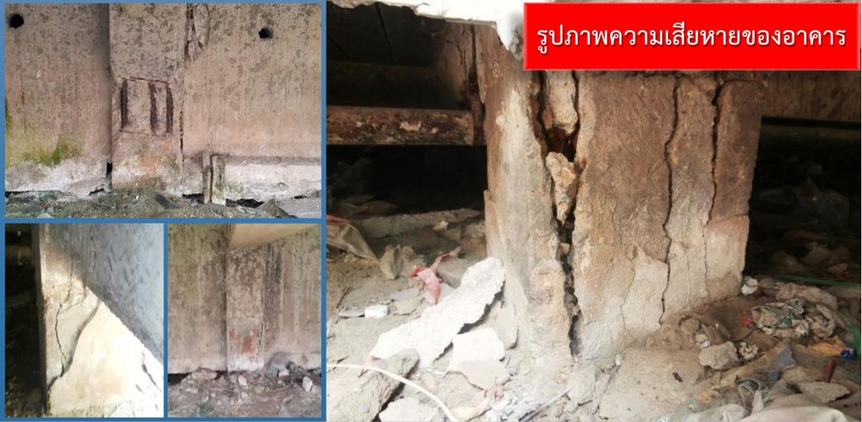
ภาพความเสียหายของตอม่ออาคาร
