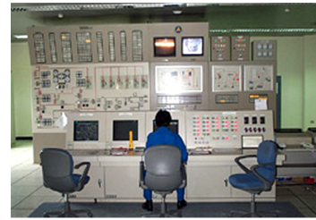
ห้องควบคุมการทำงาน
