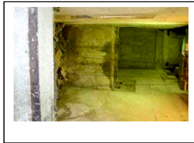
บ่อพักเถ้า (Ash Pit)
