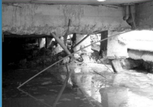
รูปที่ 1 ด้านข้างของอาคารเก่าหลังนี้เป็นเนื้อเดิมเก่า เจาะช่องบดเพื่อระบายน้ำออกจากบ่อเพื่อตากดินไปใหม่ ปัจจุบันก็มีบันไดลงมาจากด้วยทำให้มีอาคารใหม่เคลื่อนลงไป เนื่องจากเคลื่อนตัวของดินเก่าไปเสาริมเคลื่อนหลุด
